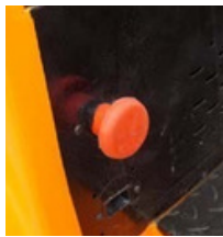
Dispositivo de paro de emergencia
